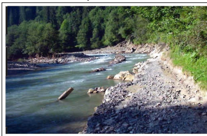
podmyta przez Czeremosz droga niedaleko Dżembroni
